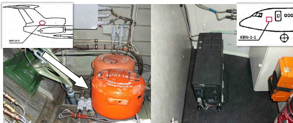
Рис. 10. Место установки аварийного накопителя МЛП-14-5 в защитном корпусе (снимок слева) и КБН-1-1 (снимок справа)
